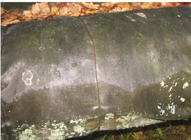
Рис. 12. Лишайники на обшивке теплотрубы
