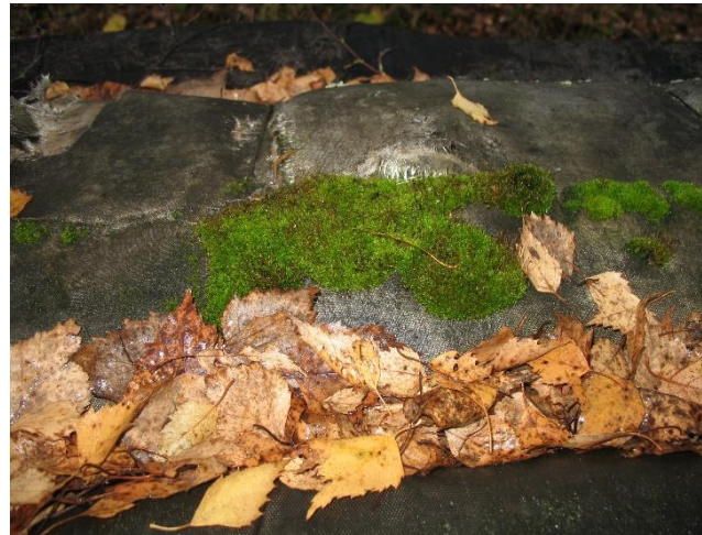
Рис. 11. Мох на обшивке теплотрубы
