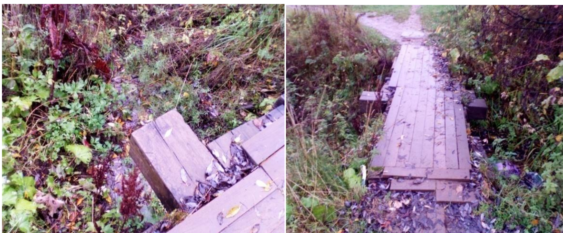
Рис.16,17. Пересохшая канава и мостик через нее на ул. Советская, д. 1
