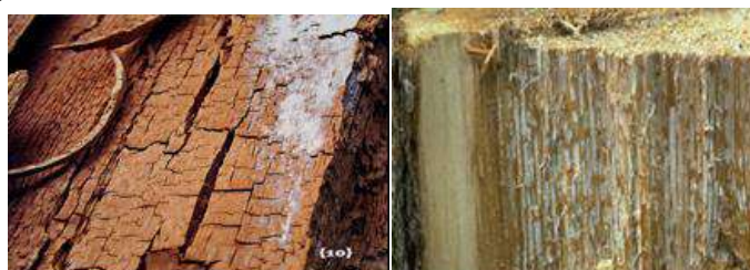
Рис. 1. Деструктивное и коррозионное разложение древесины
