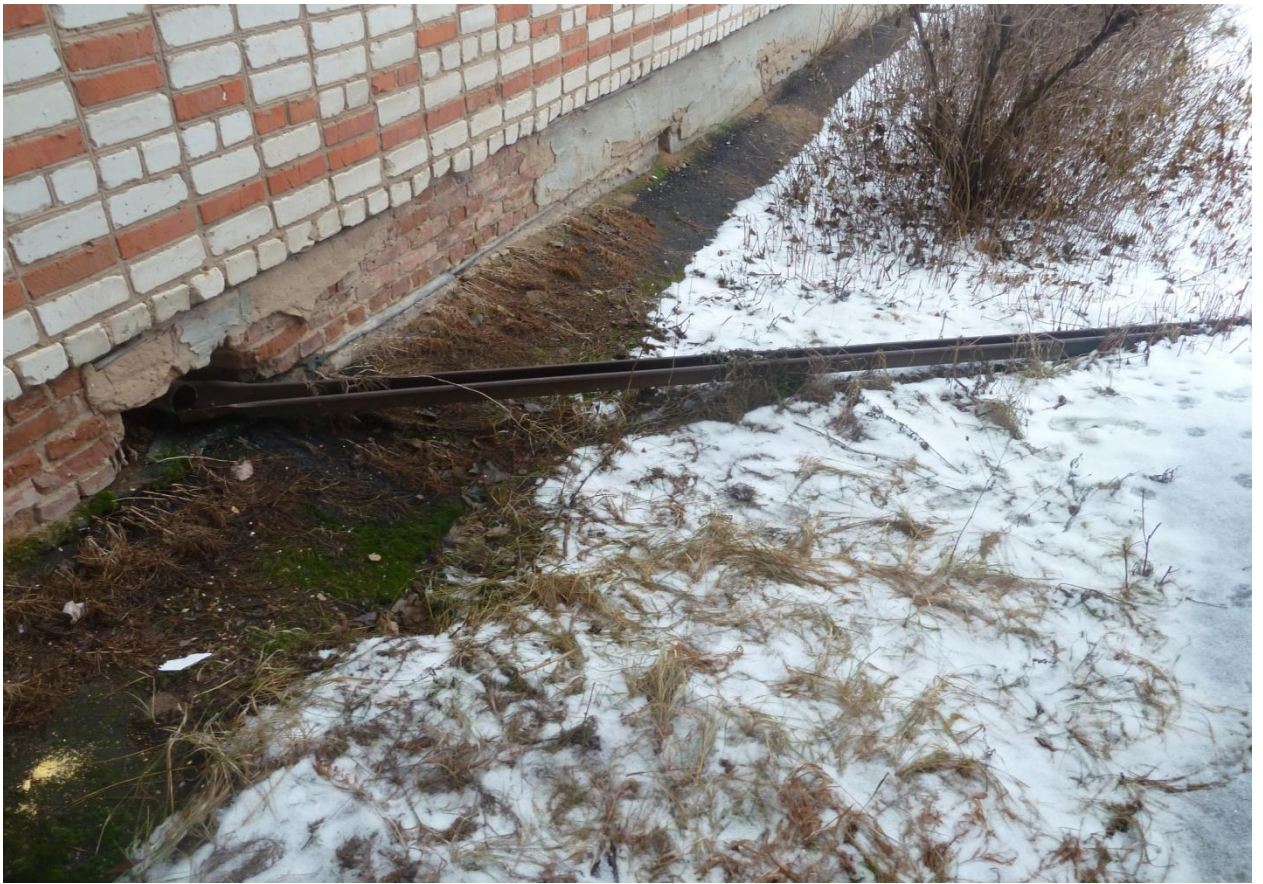
Фото 3. Влияние влаги на состояние цоколя.
