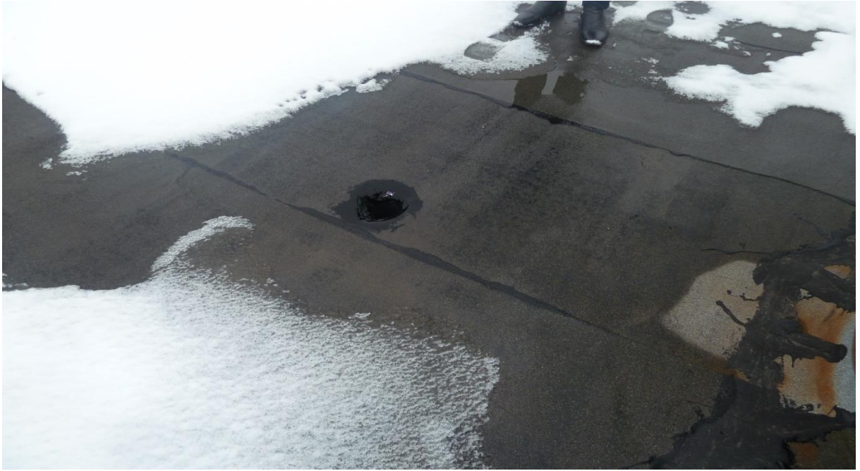
Фото 1. Воронка на крыше для слива воды.
