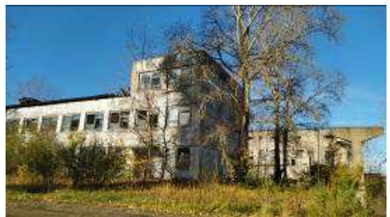
Рис. 24. Разрушенные корпуса фабрики
