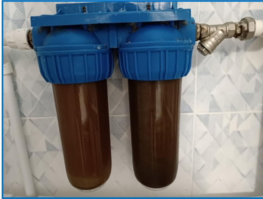
Рис 1. Состояние домашнего фильтра после 4-х недельной эксплуатации
